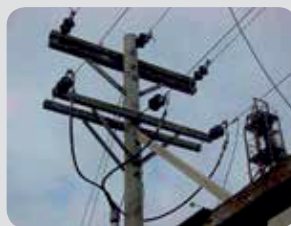
Chyba rozvodného vedení
